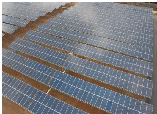
《ロジャナ工業団地に設置している太陽光パネル》
