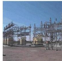
発電設備 (Santa Fe)
