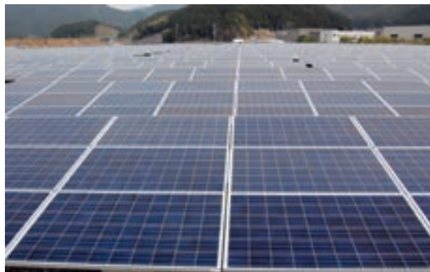
兵庫県丹波市の太陽光発電所
