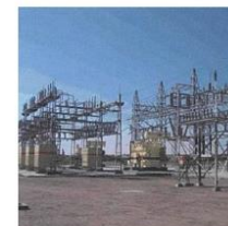
発電設備 (Santa Fe)
