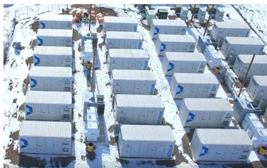
所在地: 米国コロラド州 容量: 235MWh
