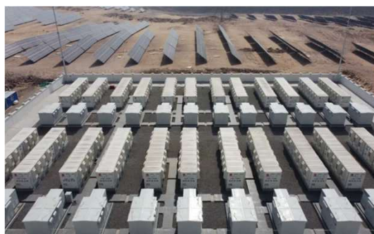
所在地: 中国 内モンゴル 容量: 235MWh
